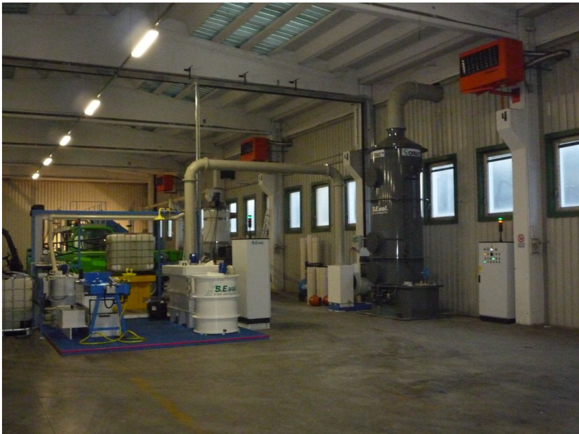
Мини завод по переработке от 1000 до 4000 т/год отходов
