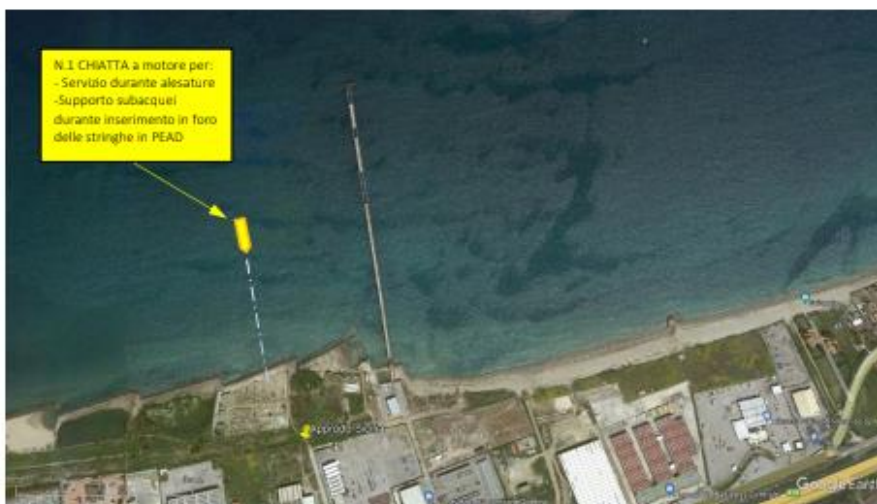
FIG. 6.03 CANTIERE A MARE: CHIATTA A MOTORE E BARCHE DI TONNEGGIO TUBI PEAD
