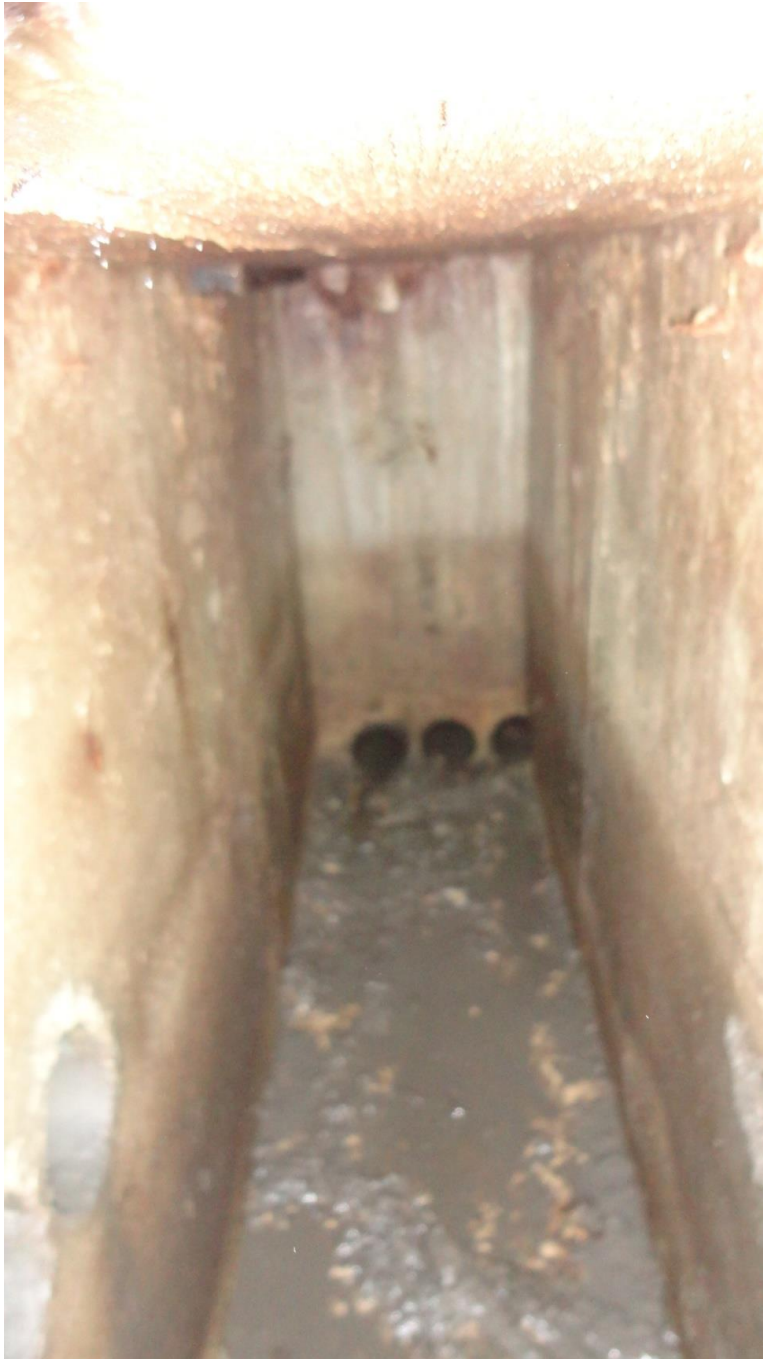
PIAZZALE TRA STIVA 5A E STIVA 6 CAMERETTA IN PROSSIMITA' DEL MODULO 4 DELLA STRINGA LI-5A
